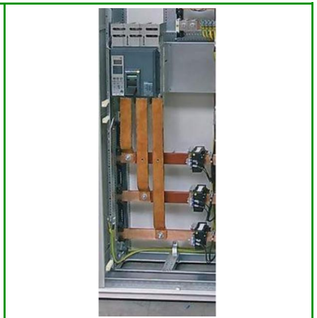
Systemlösung 185 mm Sammelschiene bis 630-1000 A für Schneider Leistungsschalter (NS)
