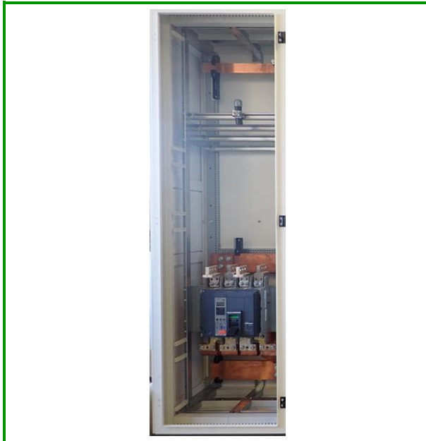
Systemlösung 185 mm Sammelschiene bis 1000-1600 A für Schneider Leistungsschalter (NS)
